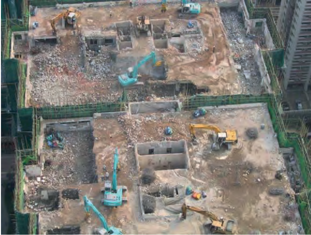
Görsel 8 Söküm İşlemleri Sonrasında İş Makinaları ile Seçici Yıkımın Yapıldığı Bir Şantiye
