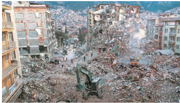
Görsel 29 2023 Kahramanmaraş Depremi Sonrası Antakya'da Enkaz Kaldırma Çalışması Esnasında Görüntülenen Yıkıntı Atıkları 30 [42]
